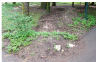
Slika 33. Nestručno izvedeni radovi u nelegalnom iskopu na početku staze br. 6
